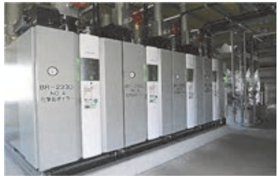
(貫流ボイラー)
